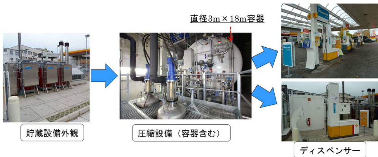
図3. 15 水素供給フロー
