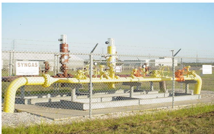
図3. 11 EV バルブステーション
