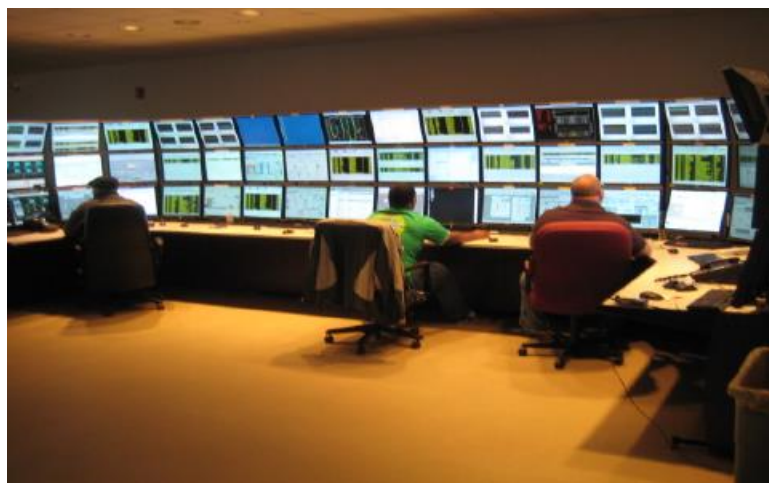
図 3. 10 遠隔集中監視システム コントロールセンター
