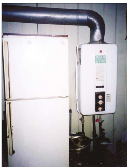
設置状況と腐食の状態
