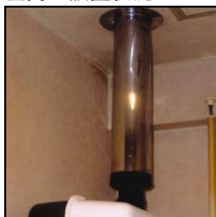
屋内の設置状況は
