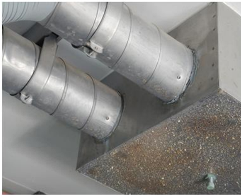
現場排気ダクト接続部拡大
