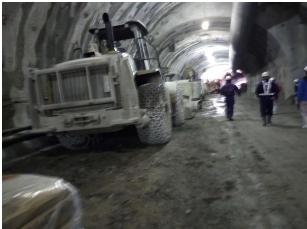
写真4 負傷者が退避していた重機（奥が切羽）
