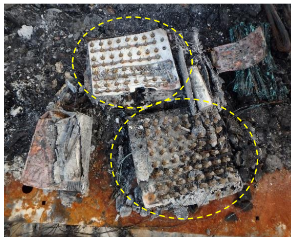
図 9 モジュール 2 台の残骸（商用車内）
