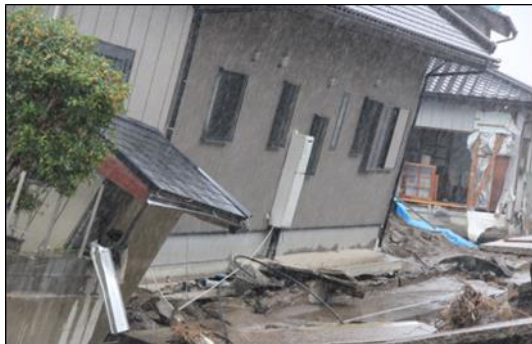
濁流により土台の傾いた住宅
