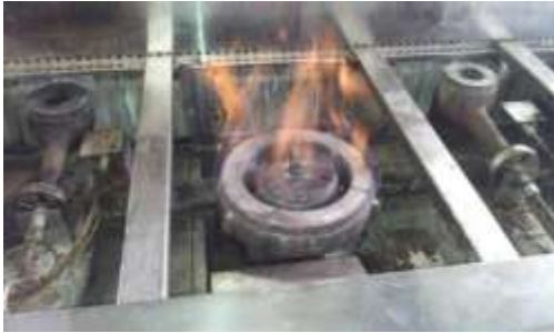
劣化による不完全燃焼
