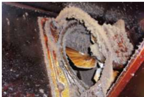
汚れた換気扇
