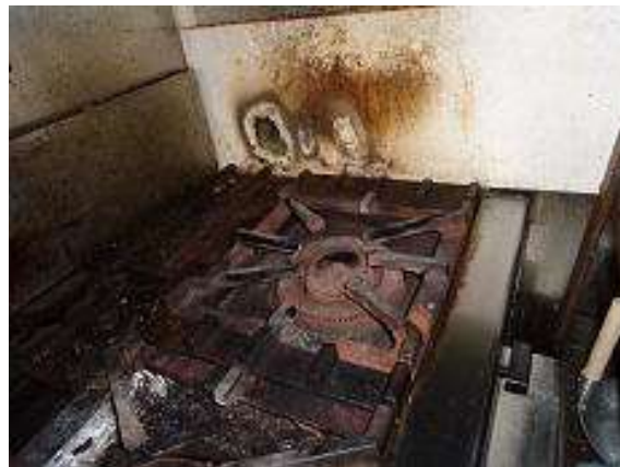
レンジ周りの油に引火した跡
