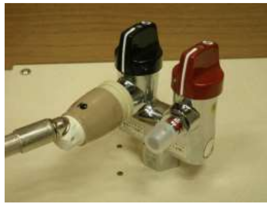
保護キャップを装着したガス栓
