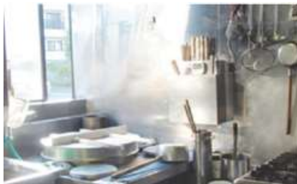
窓や勝手口を給気口、排気口としているケース
