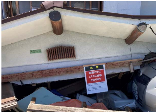
LPガス容器が残っている表示を行った。
