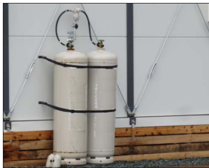
仮設住宅への LPG 供給
