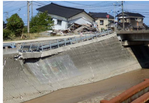
破損した大谷川の法面
