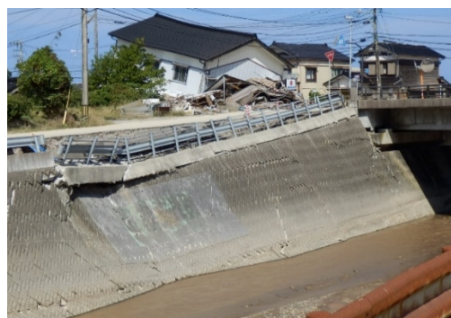
破損した大谷川の法面
