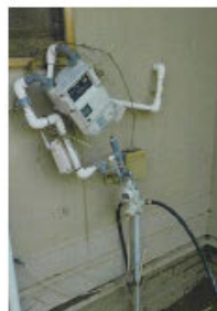
LPガス設備の損傷
