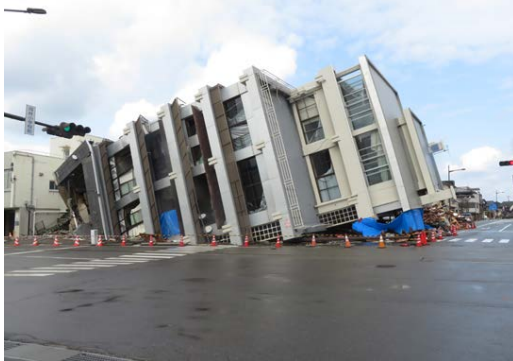
輪島市の倒壊した7階建ビル
