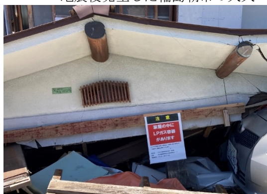
LPガス容器が残っている表示を行った
