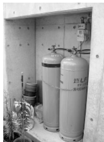
建物凹み部分への設置
