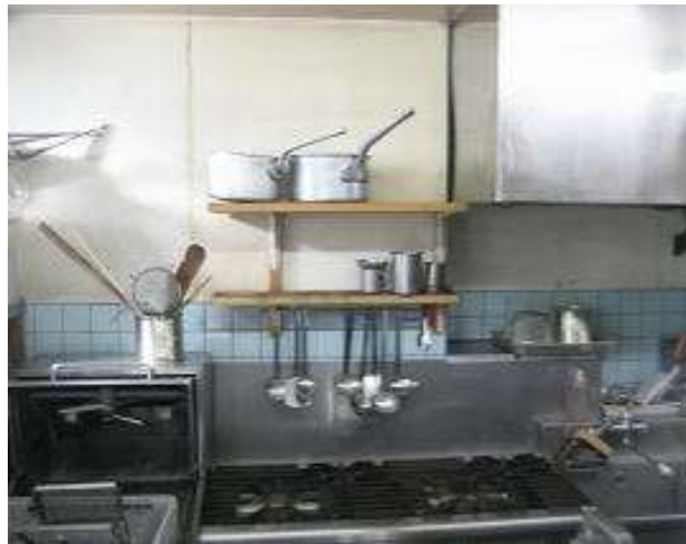
レンジフードからはみ出たレンジ
