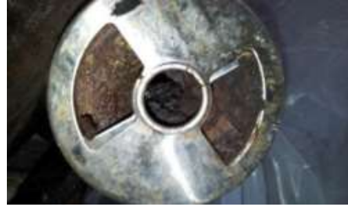
給気口の腐食
