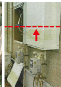
冠水した給湯器
