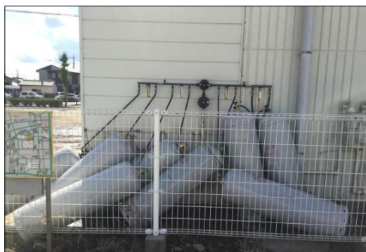
濁流により流出寸前の容器
