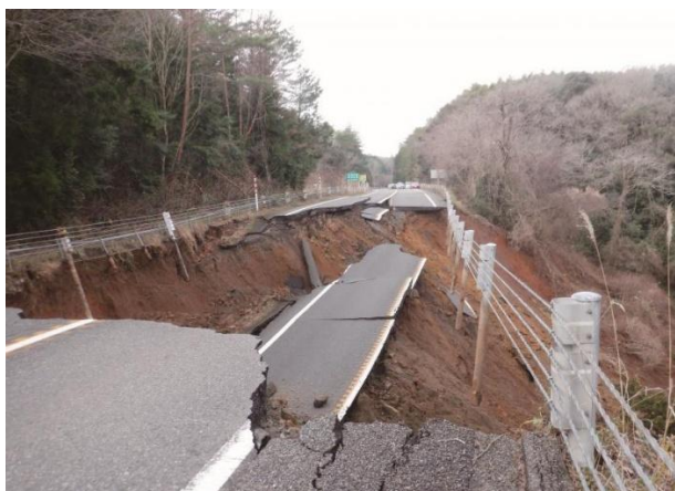
能登半島では多くの道路が崩落、孤立した
