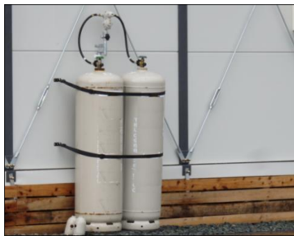
仮設住宅への LPG 供給
