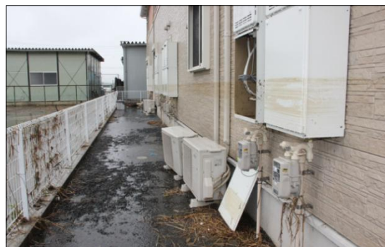
給湯器の高さまで水没した形跡が見られる
