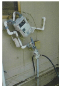
LPガス設備の損傷
