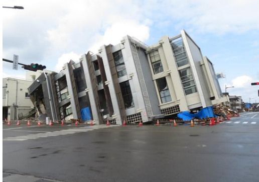
輪島市の倒壊した7階建ビル
