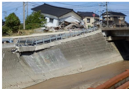
破損した大谷川の法面
