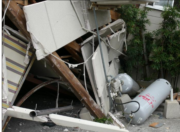
地震で倒壊し家屋で被害のあった LP ガス供給設備【プロパン・ブタンニュース提供】
