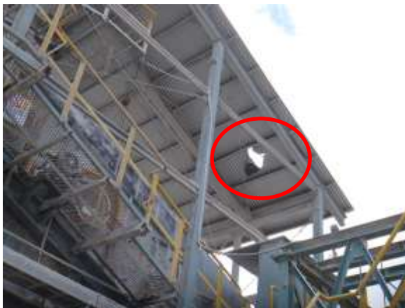
プラントの1次スクリーン建屋屋根破損(○印)
