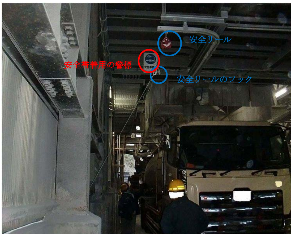
写真2 災害現場における安全帯着用警標及び安全リール
