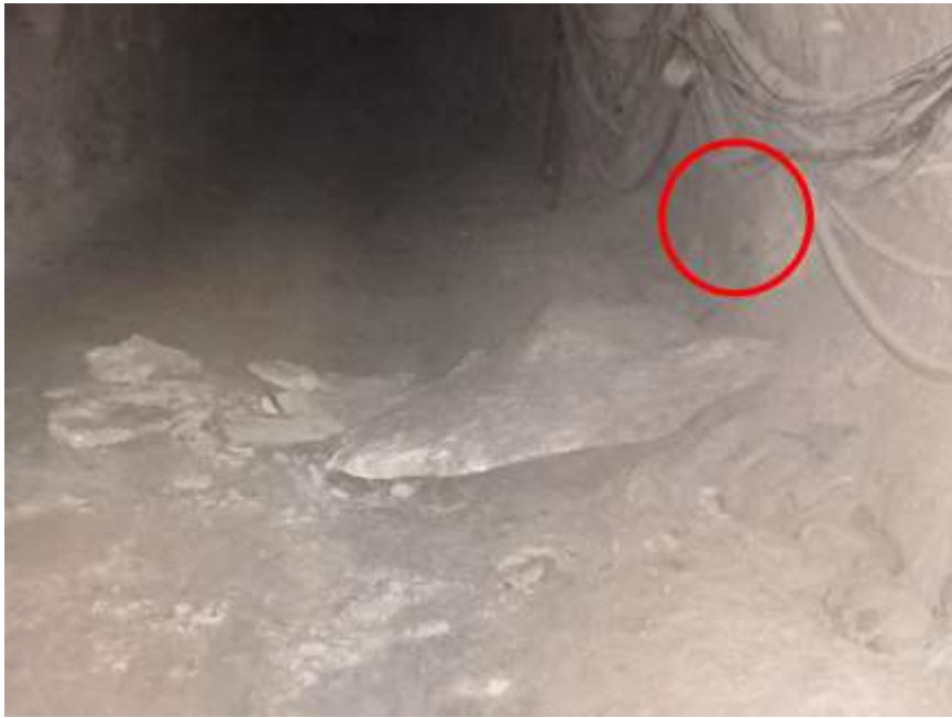
(赤丸箇所罹災箇所／落盤と側壁に挟まれる)
