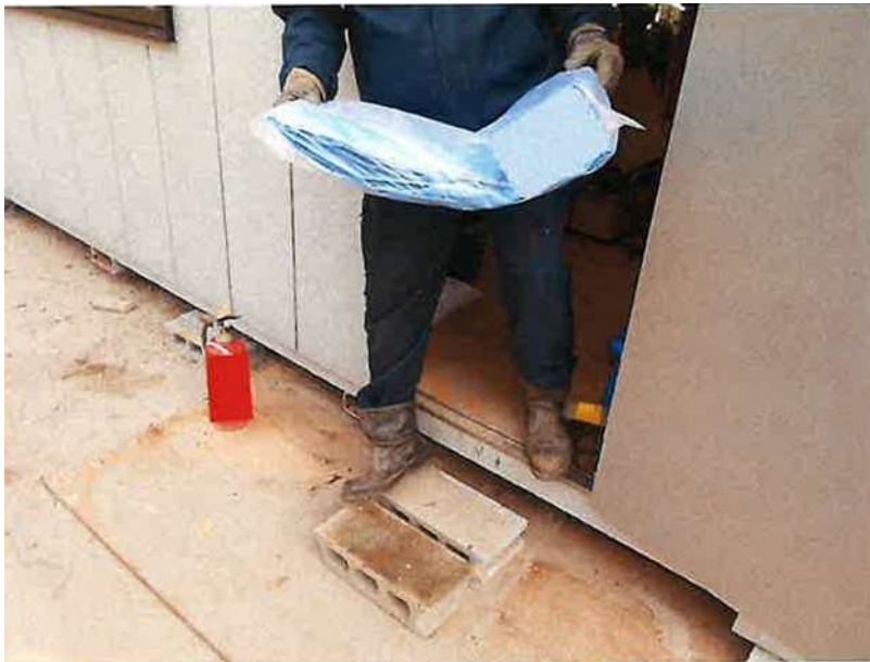
写真2 災害発生状況（足の踏み外し）
