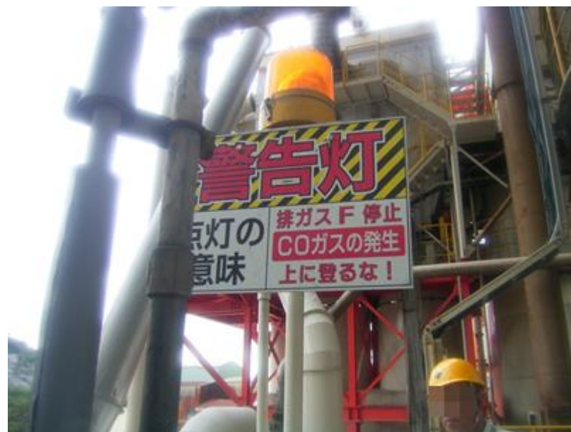
COガス警告灯
