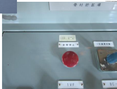
操作盤非常停止スイッチ
