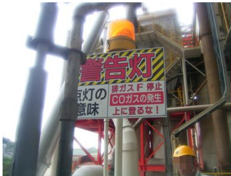
COガス警告灯
