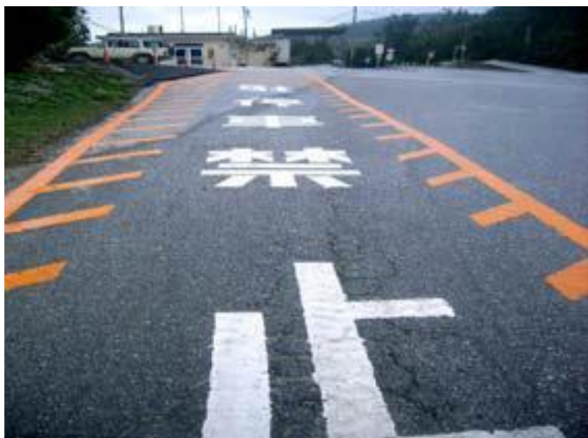
傾斜地を駐停車禁止帯とした
