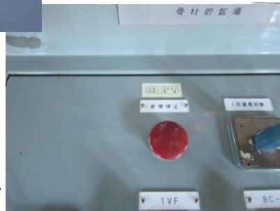
操作盤非常停止スイッチ
