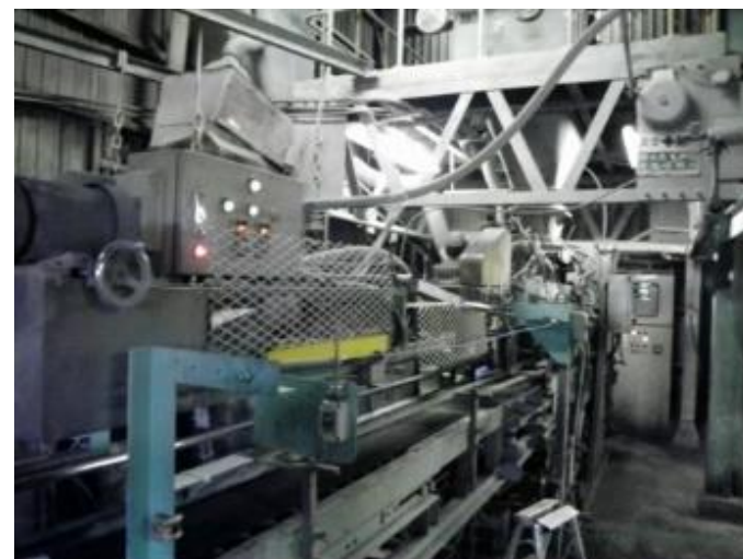
ロープスイッチを設置した装置
