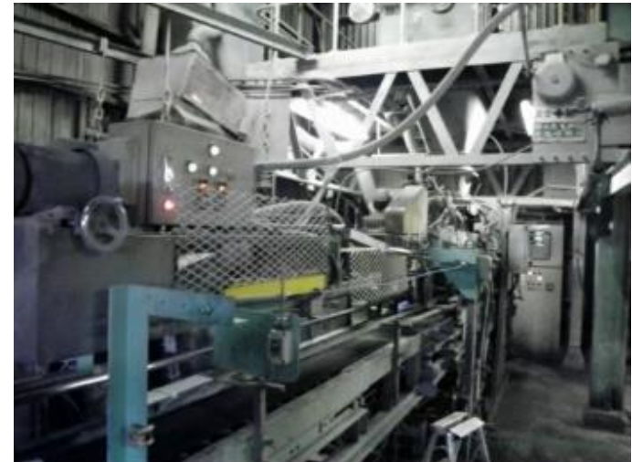
ロープスイッチを設置した装置
