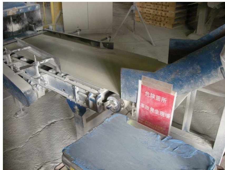
製品積込み場所でのフォークリフトの衝突による災害現場
