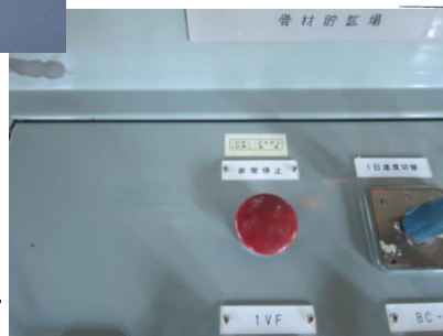
操作盤非常停止スイッチ
