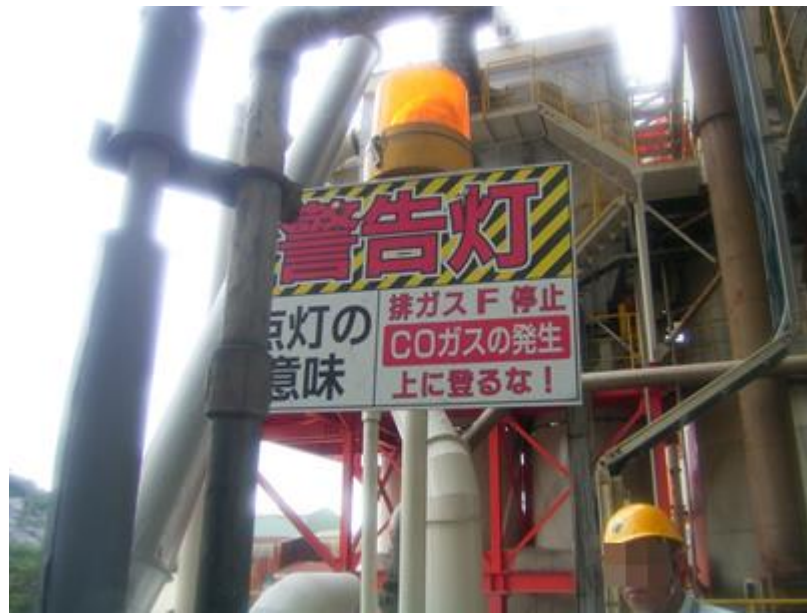
COガス警告灯
