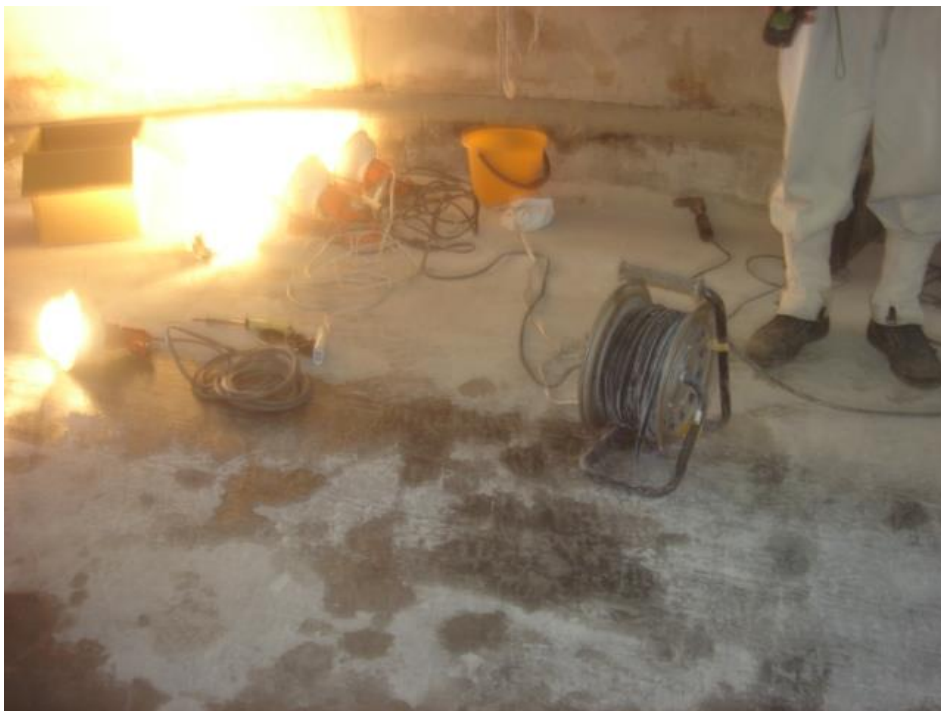
使用電力が大きい電気機器を複数接続し通電
