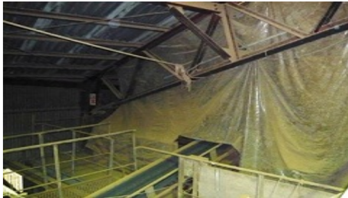
貯鉱槽上部のビニールシート状況
