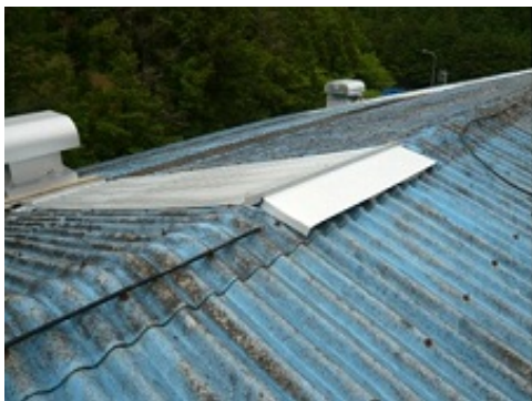
屋根排気ファン（２基）
