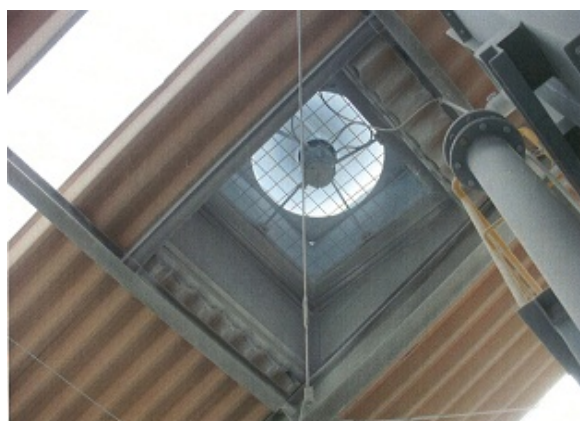
増設した天井の換気扇
