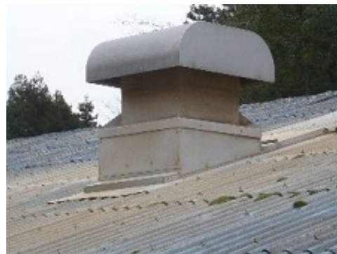
屋根排気ファン（拡大）
