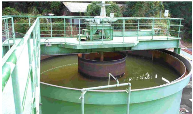
写真3-3 : 上昇流型沈降分離槽
