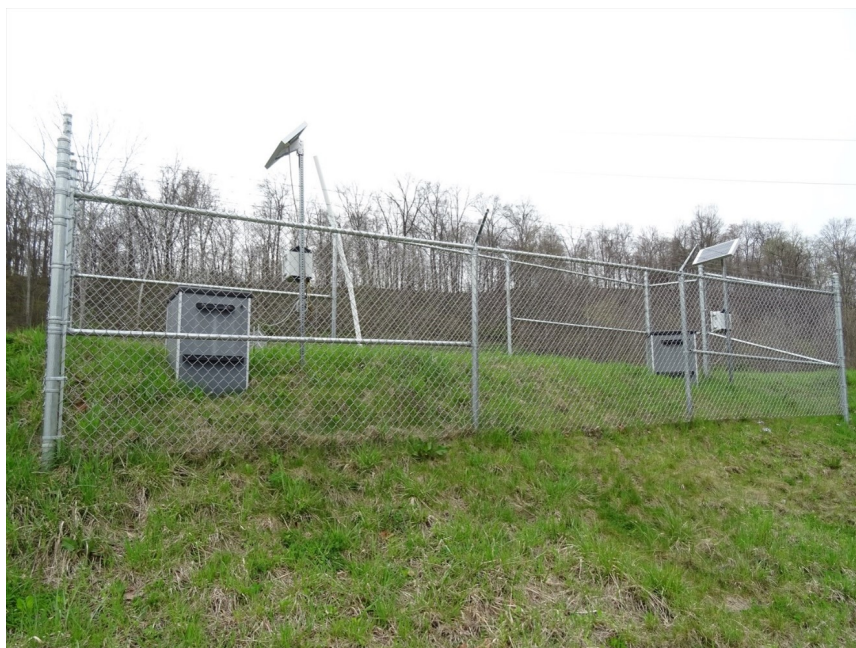
図 2-7 設置されているソーラーパネルと制御盤
