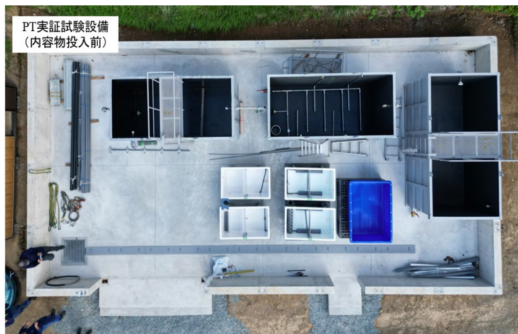
図 2.8-10 PT 実証試験設備設置状況
