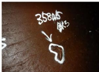
ひび割れ状況
