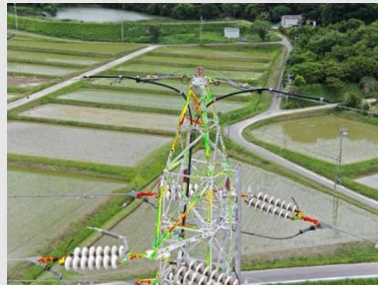
錆検出後の画像
