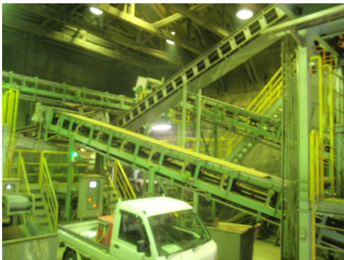
写真 3-3 造粒設備写真
