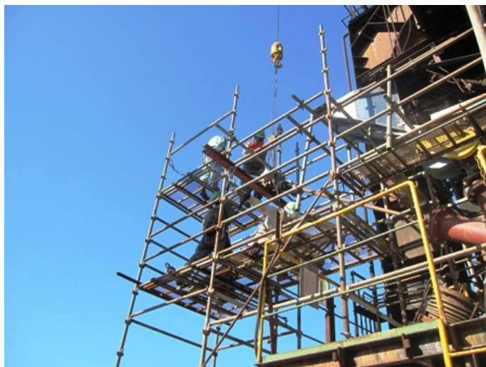
写真 3-7 焙焼炉設置時の乾式給鉱設備
