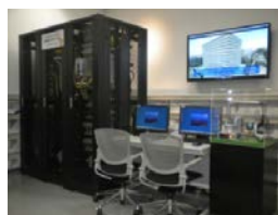
③ビル制御システム
