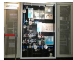
⑤下水・排水プラント
