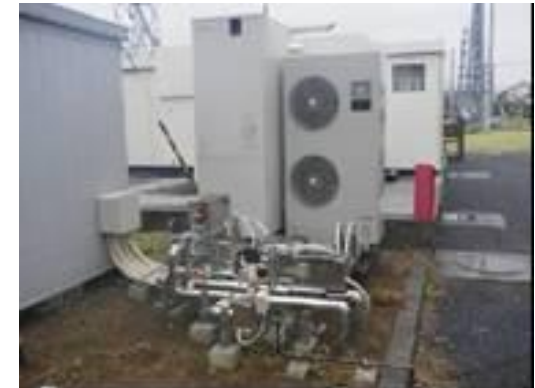
蓄熱設備(給湯用HP)
