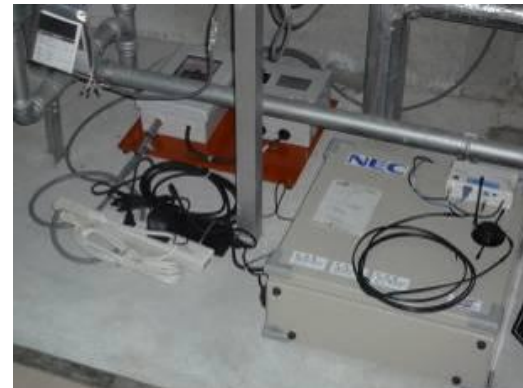
電気設備室への設置事例
