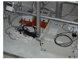
図 3－51．電気設備室への 設置事例
