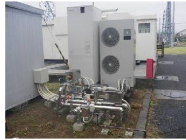
蓄熱設備 (給湯用 HP)
