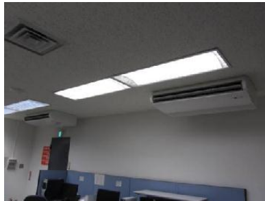
負荷設備 (照明、パッケージエアコン)
