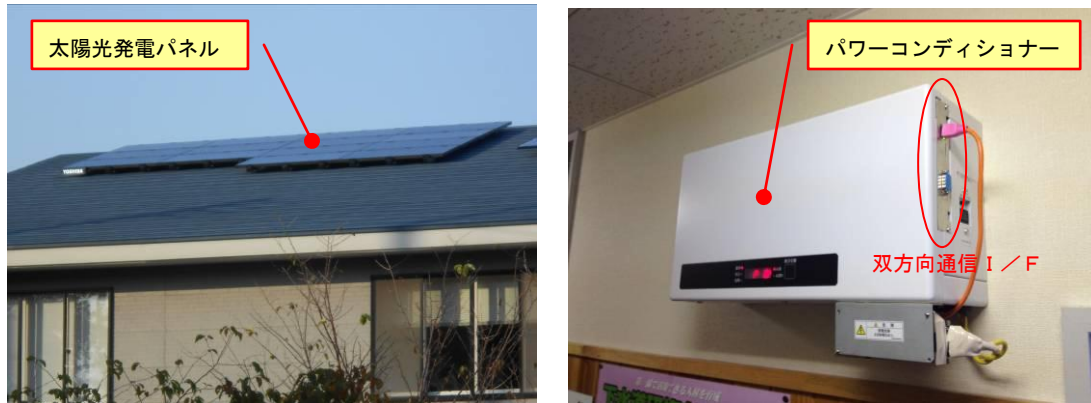
図 3－3．PV および PCS 外観
