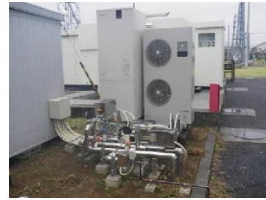
蓄熱設備 (給湯用 HP)
