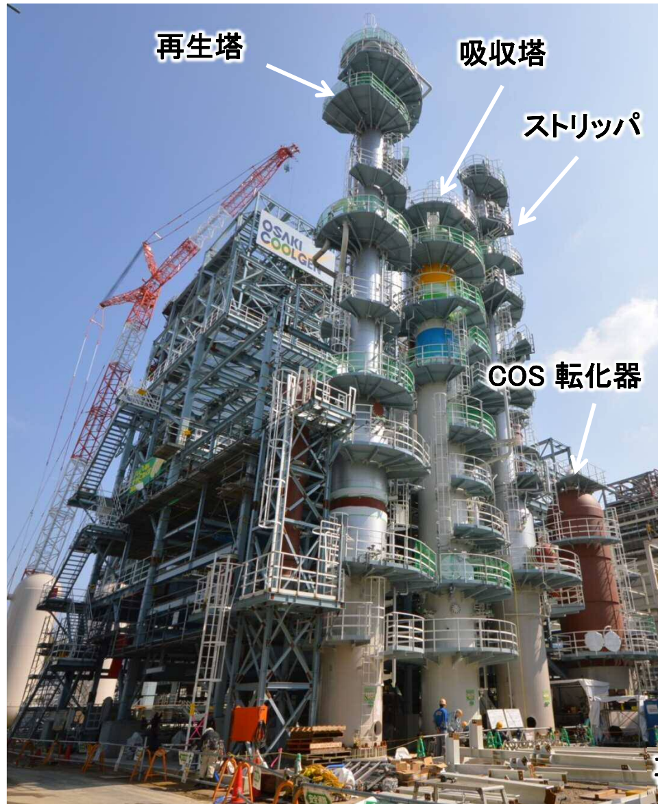
ガス精製設備
