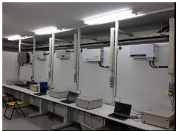
家庭用 PCS 設置状況
