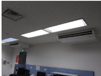
負荷設備(照明、パッケージエアコン)
