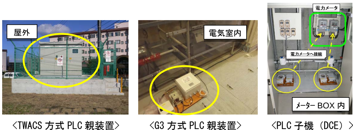
図 3－49．PLC 通信装置の設置状況
