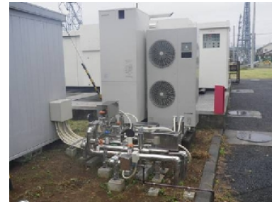
蓄熱設備(給湯用 HP)
