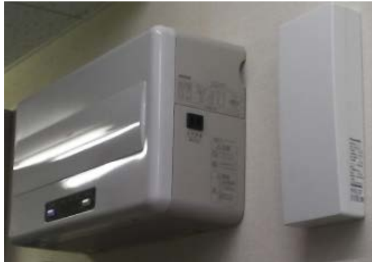
図３－５． PCS および送信ユニットの設置状態
