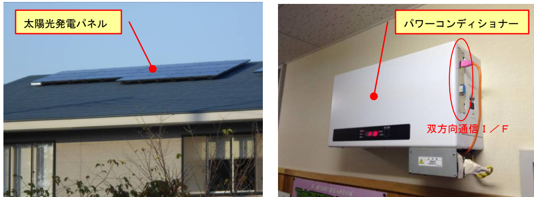
図 3－3．PV および PCS 外観
