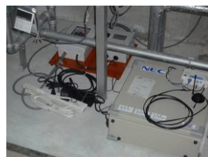
図 3－54. 電気設備室への 設置事例
