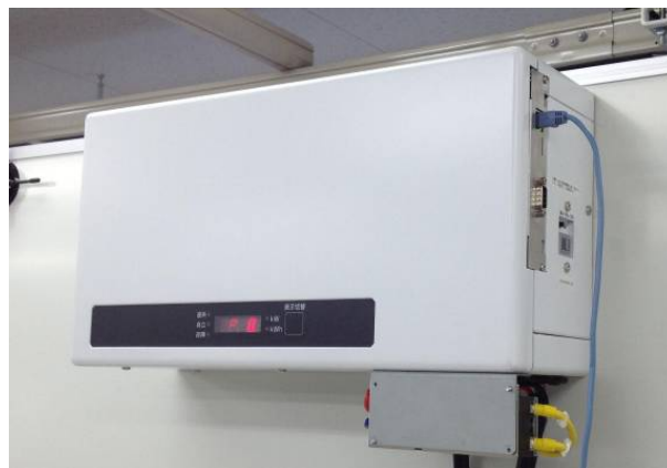
図 3－25. PCS の設置状況
