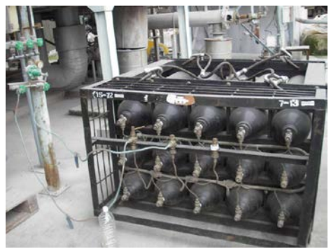
酸素ポンプ（窯内 O 2 分圧制御用）
