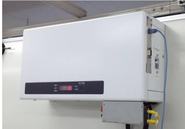
図 3－2 5．PCSの設置状況
