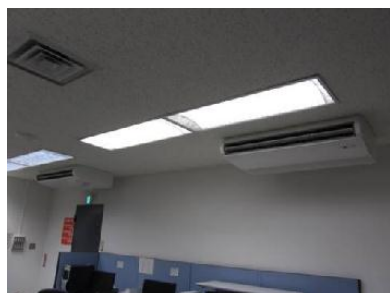
負荷設備(照明、パッケージエアコン)
