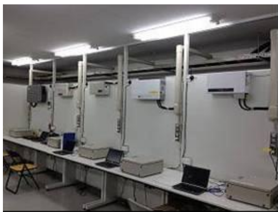
用PCS設置状況
