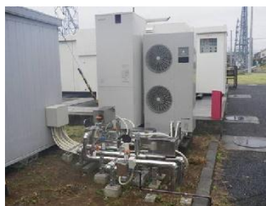
蓄熱設備(給湯用HP)
