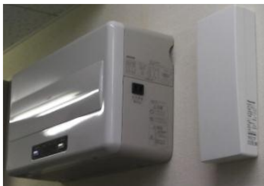
図 3－5．PCSおよび送信ユニットの設置状態
