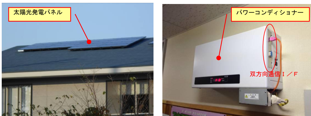
図 3 - 3. PVおよびPCS外観
