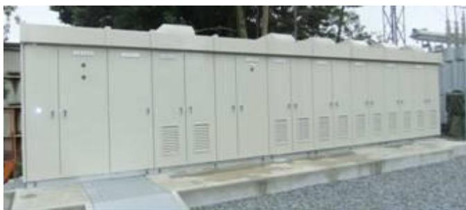
200kW NAS電池用 双方向通信出力制御機能付 PCS
