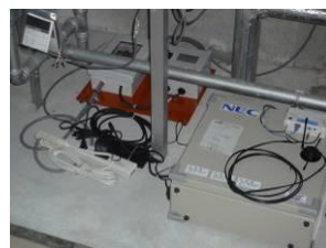
図3-54. 電気設備室への 設置事例
