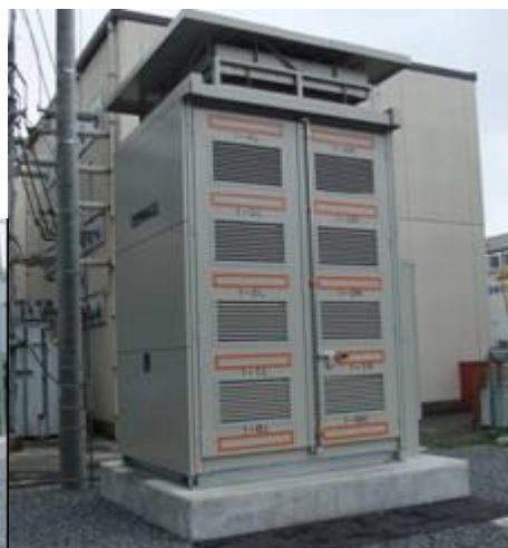
200kW NAS電池
