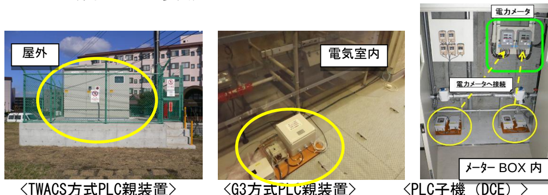
図3－49．PLC通信装置の設置状況
