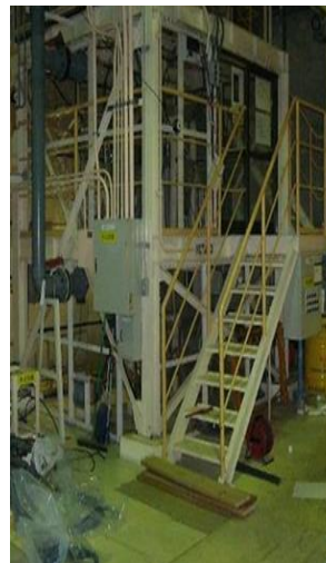
プラント機器・配管等
