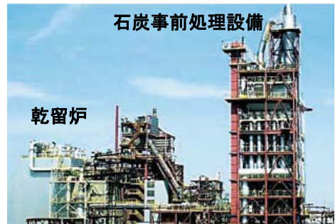
パイロットプラント外観
