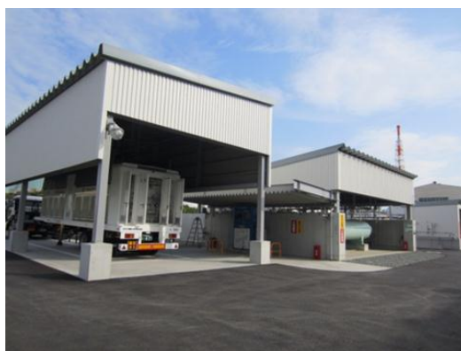
図 3 - 1 2 既設水素出荷実証設備
