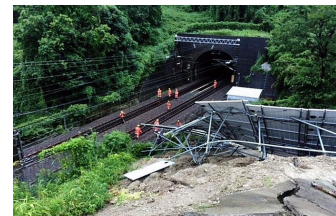
<太陽光パネルの崩落>
