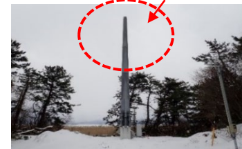
<風車の羽根の脱落>
