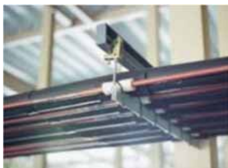
c) 冷蔵・冷凍用配管
