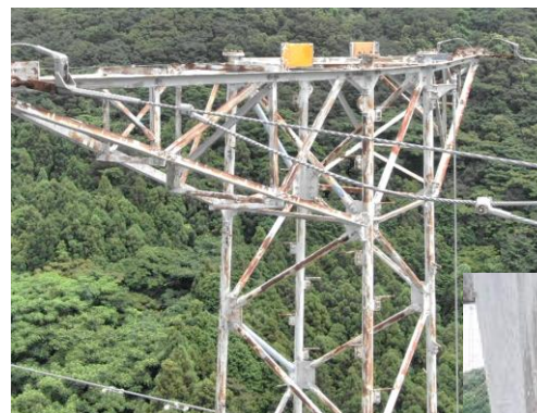
○ 鉄塔部材の劣化状況
