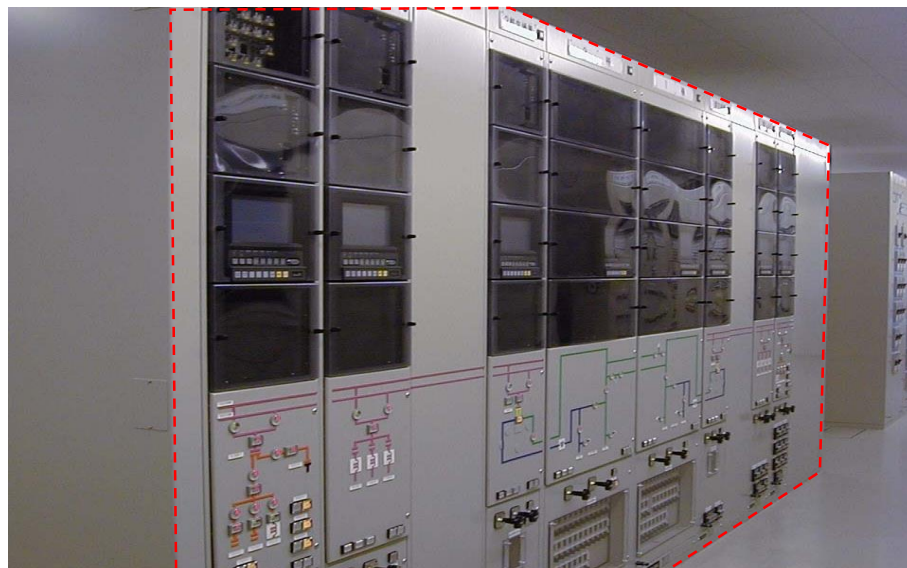
○ 変換所設備の施設状況
