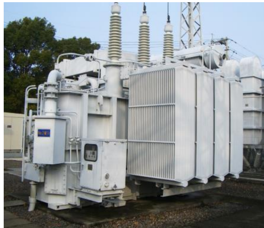
◇変圧器の施設状況
