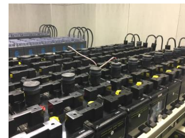
直流電源装置 (蓄電池 据置型)
