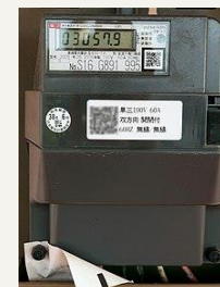
スマートメーター
