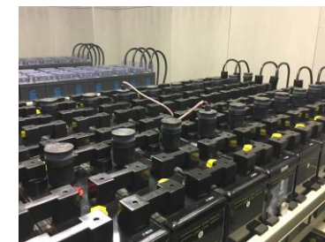
直流電源装置 （蓄電池 据置型）
