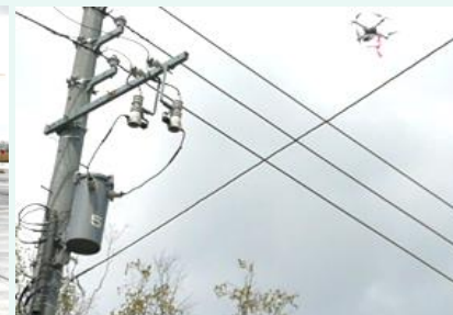
ドローンによる設備確認
