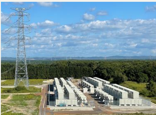
I期蓄電池 外観▶
