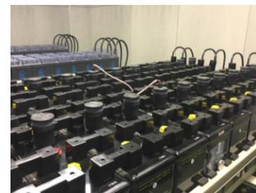
直流電源装置 (蓄電池 据置型)
