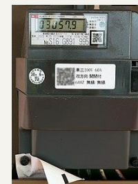
スマートメーター
