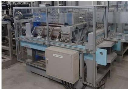
北海道電力に導入した水電解装置（2023年5月）（出所）日立造船（株）
