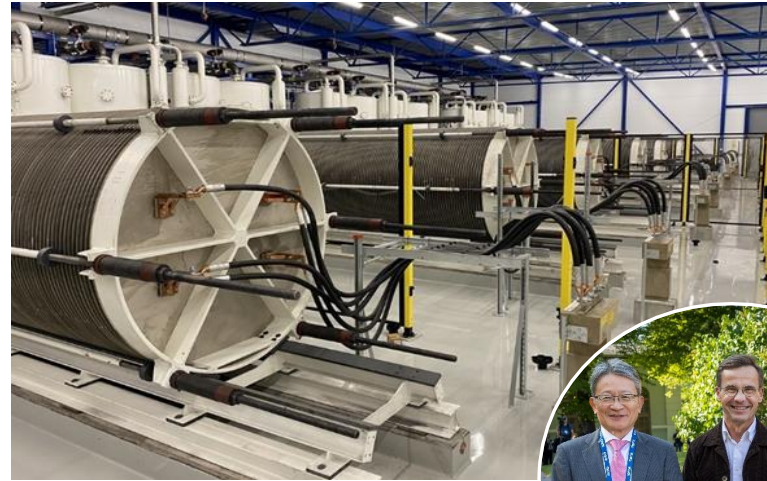
民間設備としては最大規模のOVAKO水素プラント電解装置
