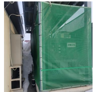
導入した非常用自家発電機
