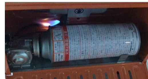
器具栓の漏えいを確認
