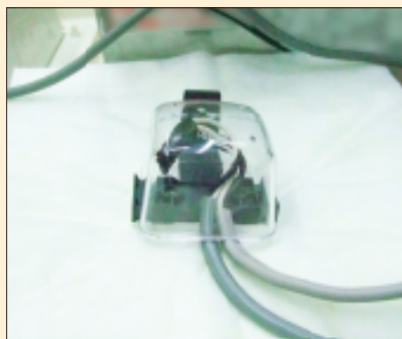
結線部に被せる埃よけジョイントボックスと不燃シート敷設による予防措置例
