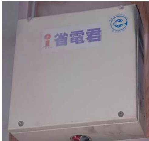
変圧器（節電器）（管理番号:A201900145）
