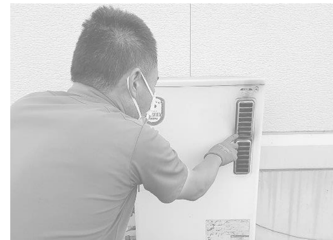
排気口の煤汚れ確認
