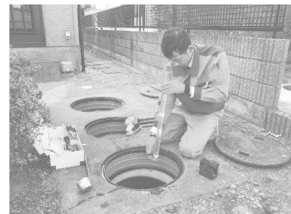
浄化槽保守点検
