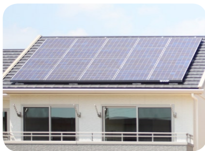
3.2KWの「太陽光発電パネル」は全戸設置
