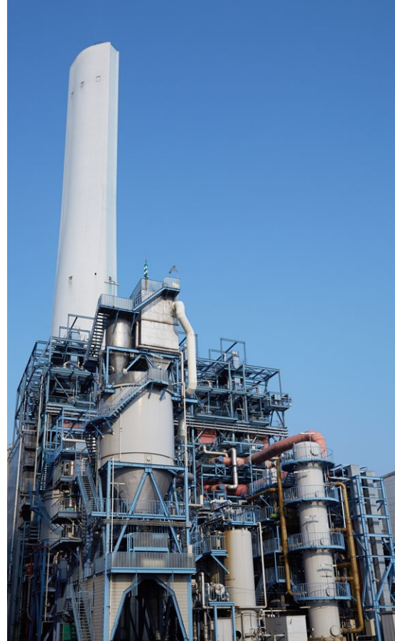
「活性コークス」という石炭からつくられた活性炭で排ガス中のSO x を吸着させる「乾式排煙脱硫装置」。活性炭は再生利用されます。
