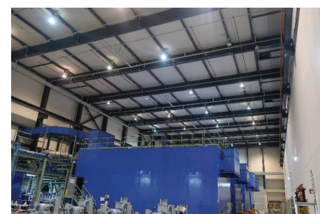
E-ディフェンスの照明のLED化
